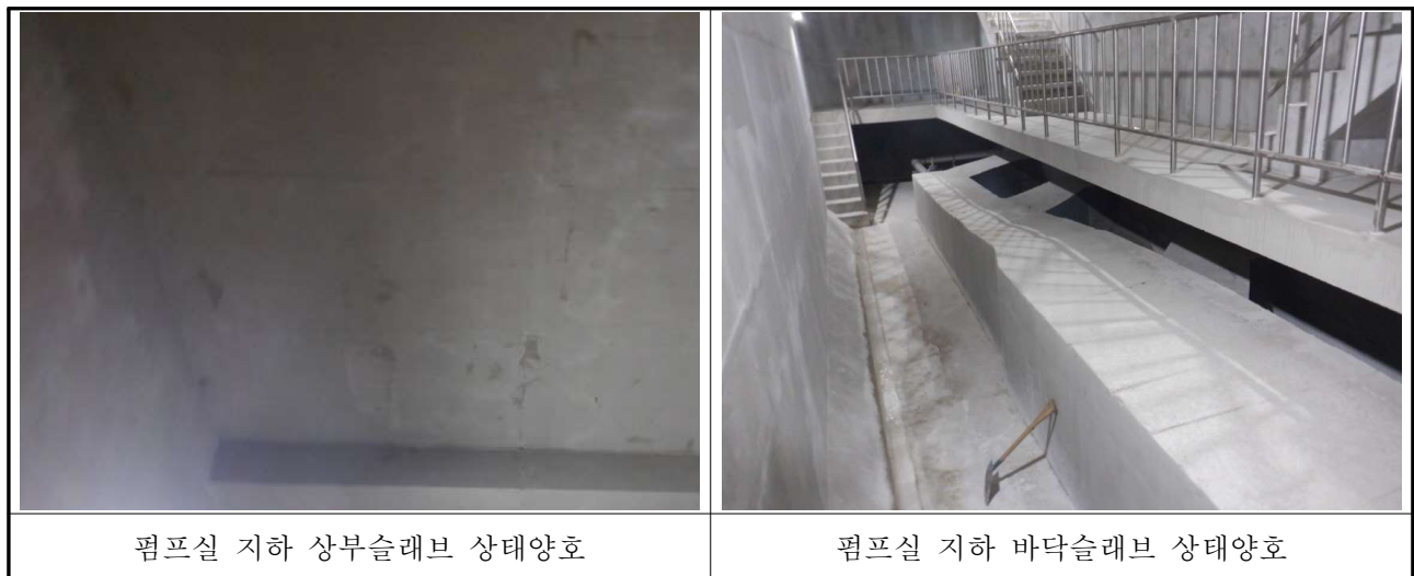
【사진 4.3】 펌프실 지하 손상사진
