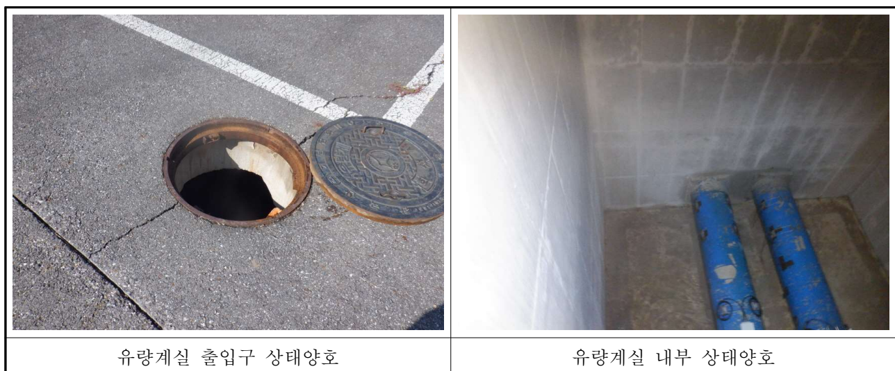
【사진 4.5】 유량계실 손상사진
