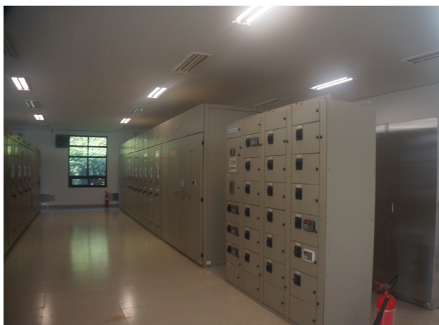
전기실 수변전설비 전경
