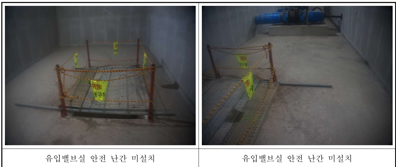
【사진 3.8】 추락방지시설 손상사진
