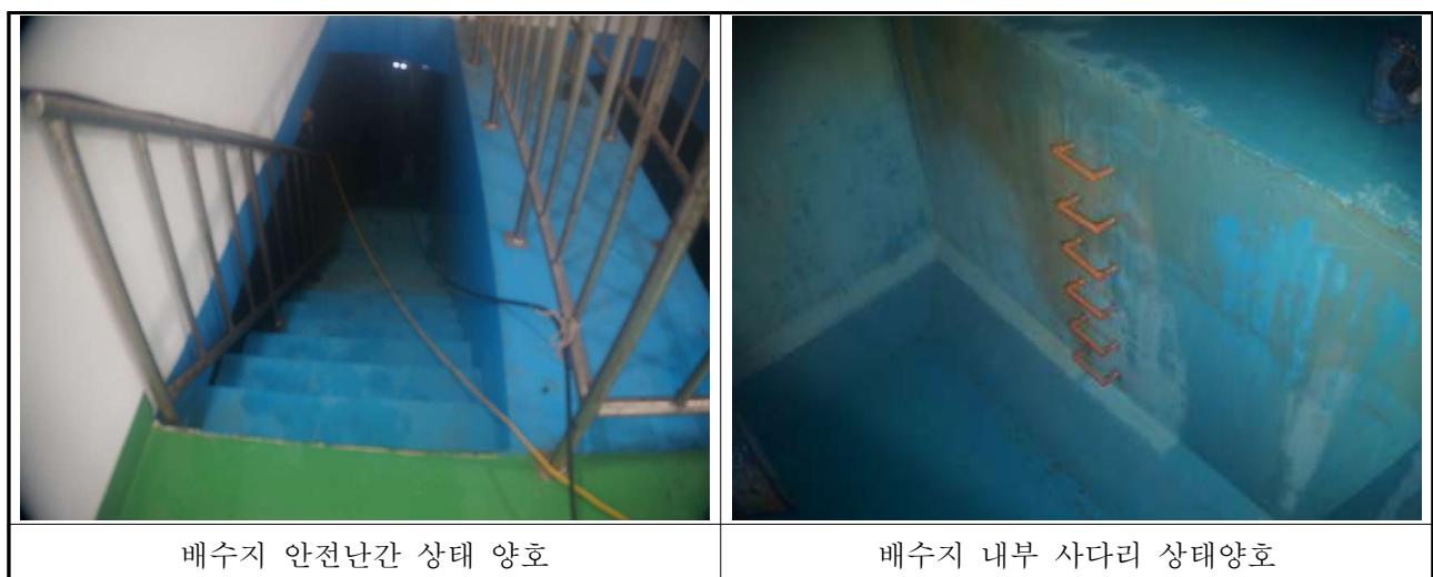
【사진 3.6】 안전시설(점검로) 손상사진
