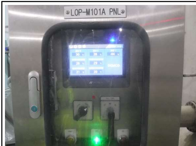
모터 현장제어반 전경
