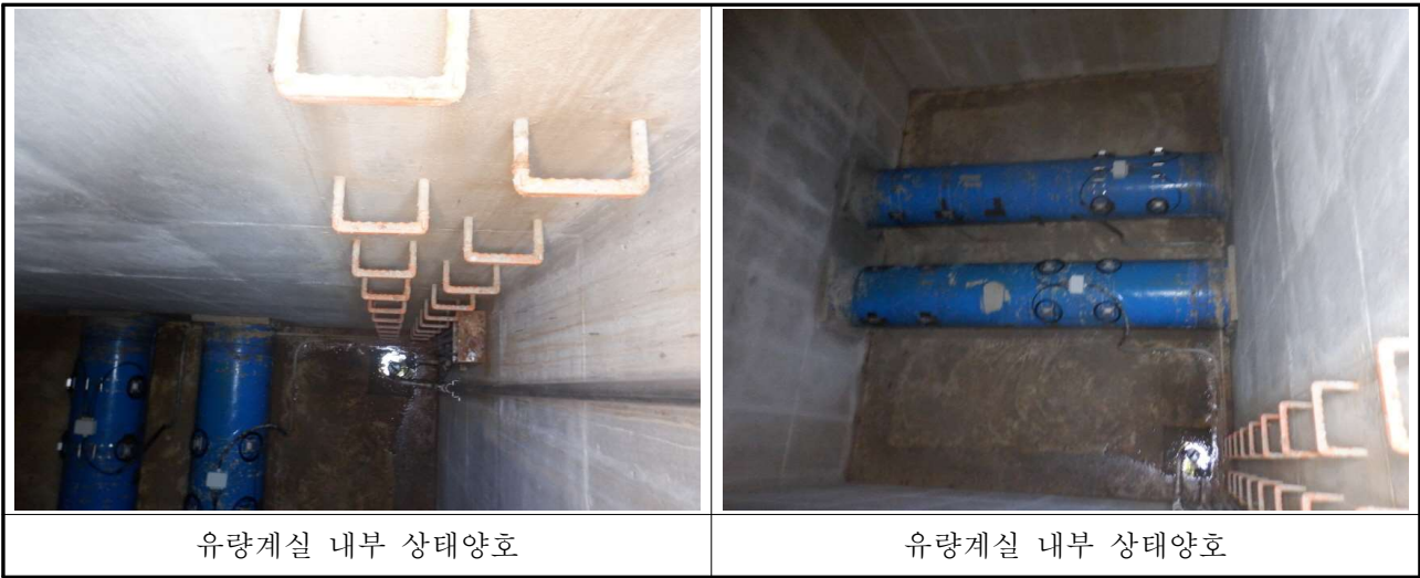
【사진 4.4】 유량계실 손상사진(계속)
