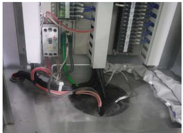
모터 현장제어반 내부 상태양호 현황
