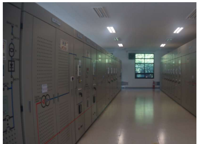
전기실 수변전설비 전경
