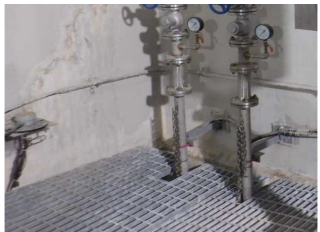
배수펌프 설치 상태양호 현황
