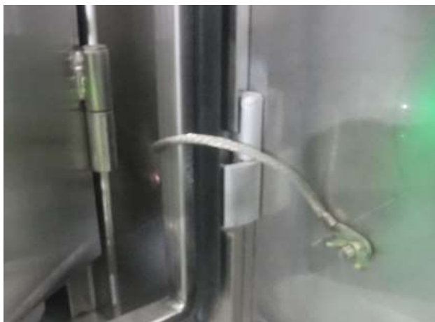
모터 현장제어반 도어분딩접지 상태양호 현황
